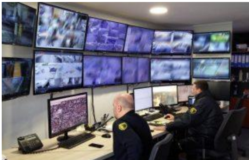
Slika 19. Predodžba centralnog dojavnog sustava
