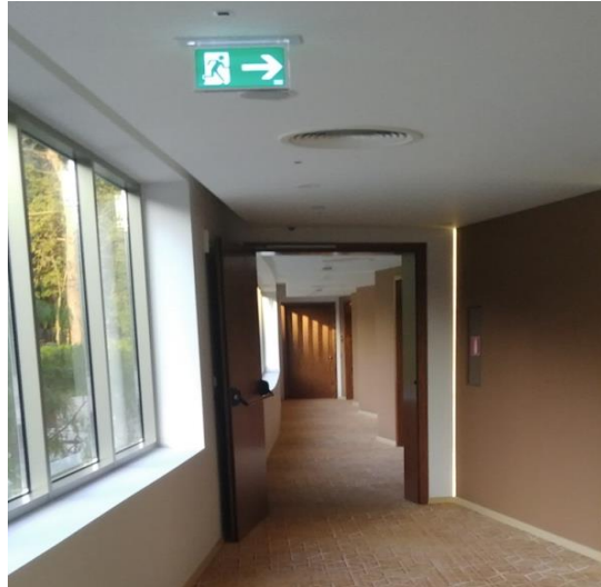
Slika 9. Protupanična rasvjeta u hotelu [10]
