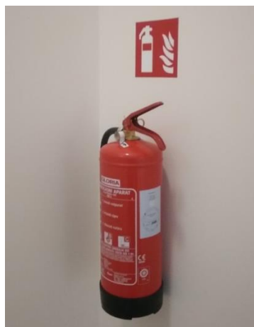
Slika 10. Pravilno postavljen i označen pp aparat [10]
