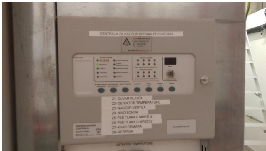
Slika 20. Centrala za nadzor sprinkler sustava [10]
