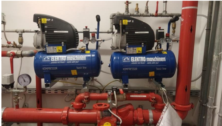
Slika 33. Kompresori za potrebe suhog sprinkler sustava [10]
