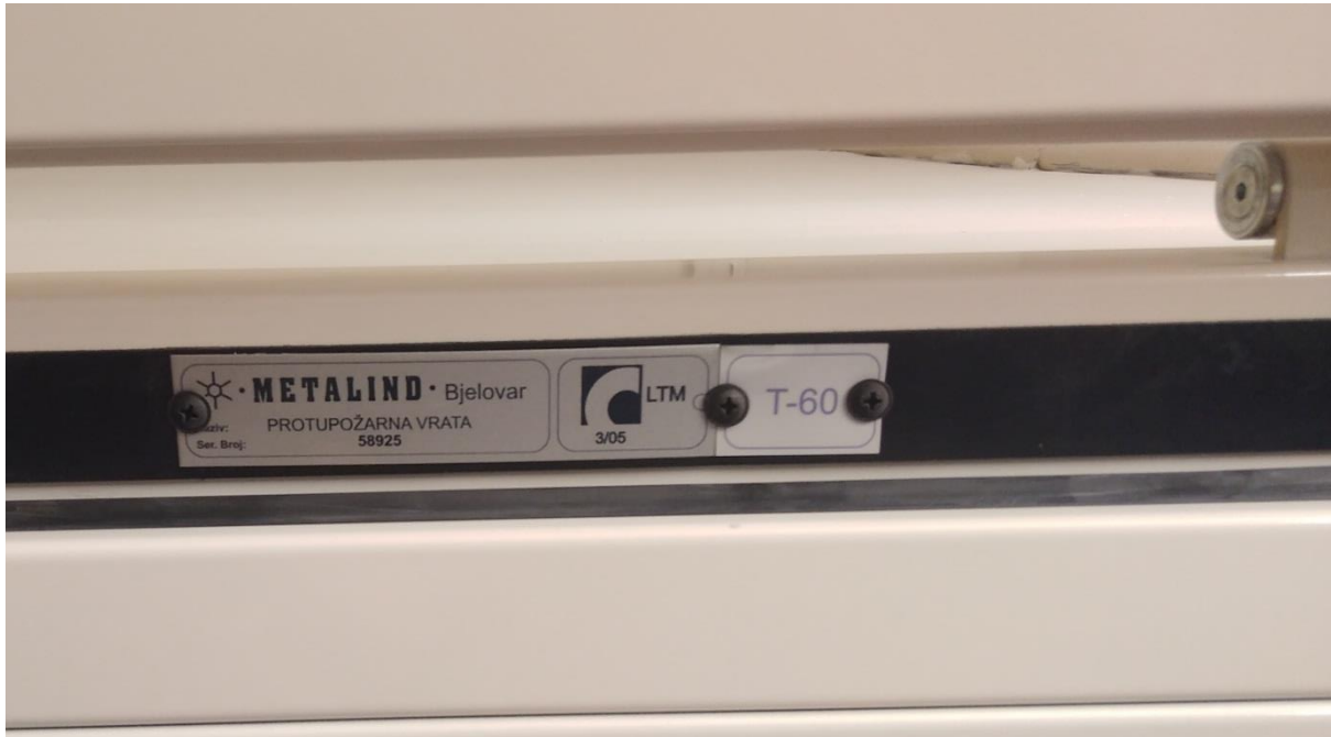
Slika 5. Vatrootporna vrata u hotelu Alhambra T-60 [10]
