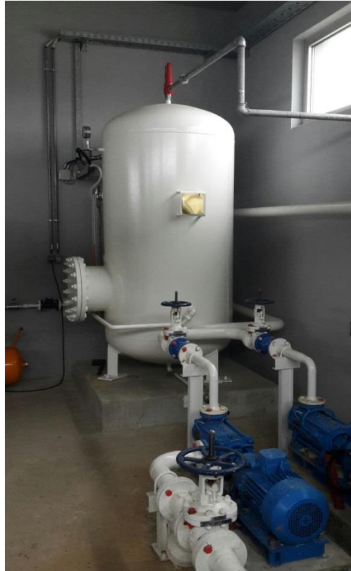
Sl. 22. Hidroforska posuda i pumpe [vlastita fotografija]
