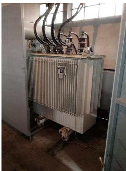
Slika 23. Predodžba transformatora, rebara hladnjaka i naponskih priključnica.
