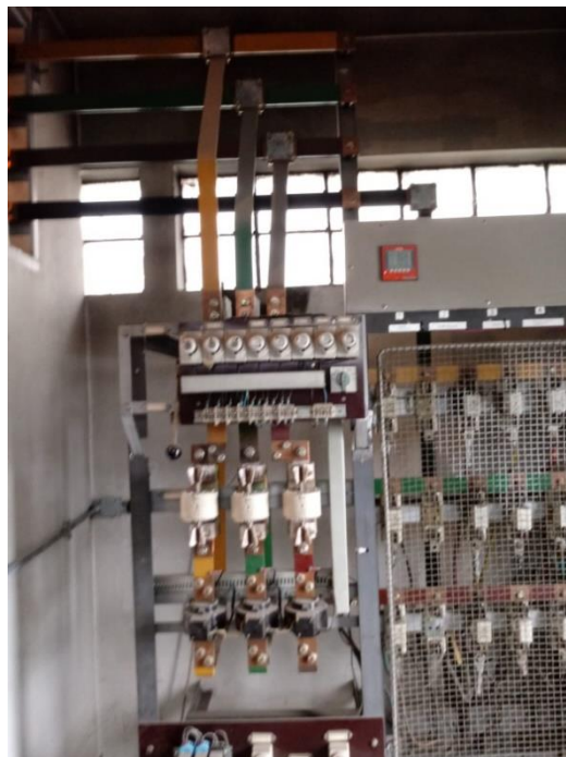
Slika 26. Predodžba RST visokonaponske ulazne faze; RST glavni osigurači 600A.
