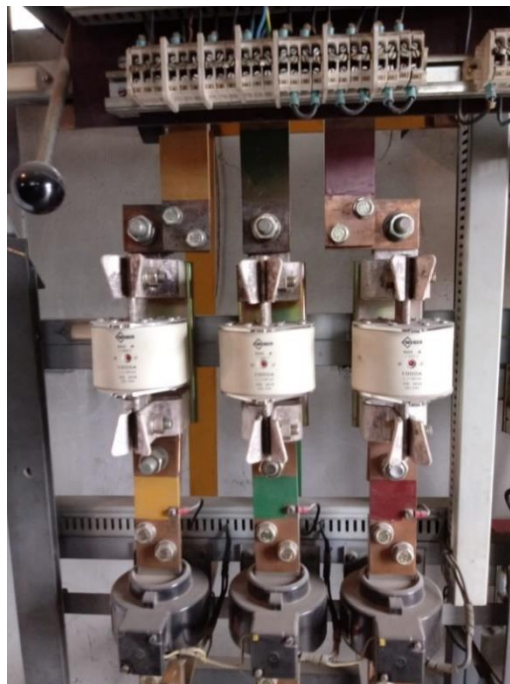
Slika 27. Predodžba glavnih rastalnih osigurača na 600A.
