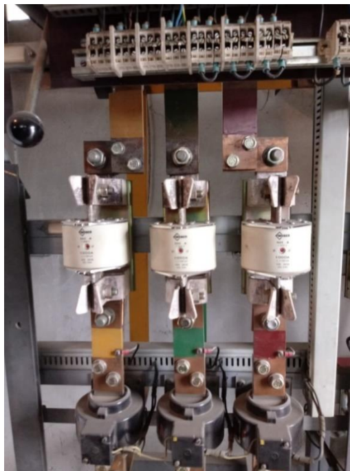
Slika 27. Predodžba glavnih rastalnih osigurača na 600A.
