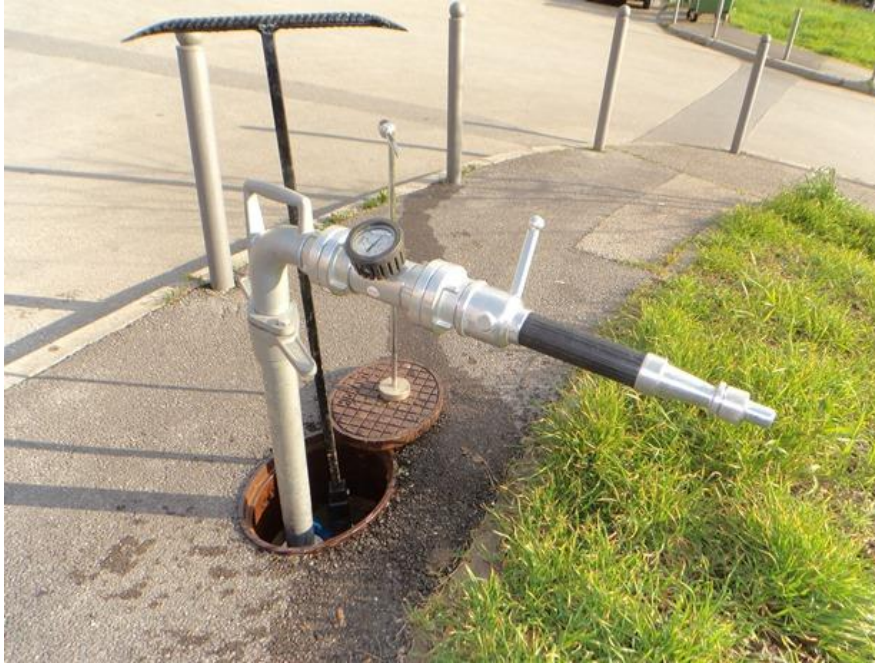
Slika 15. Ispitivanje hidrantske mreže (mjerenje tlaka i protoka vode) [18]
