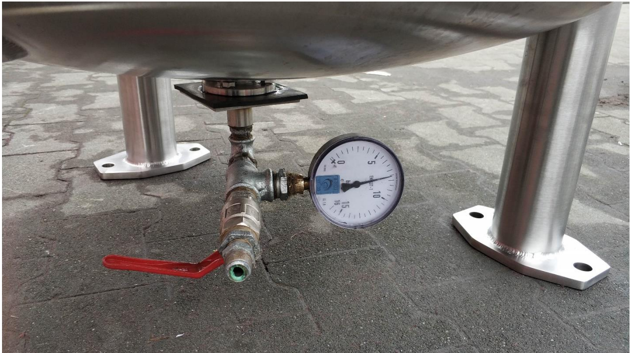
Slika 38. Prikaz manometra na totalnom ispustu
