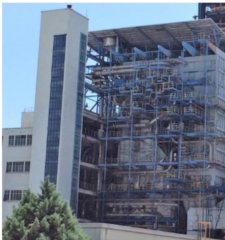
Slika 11. Generator pare TE Plomin 1.
