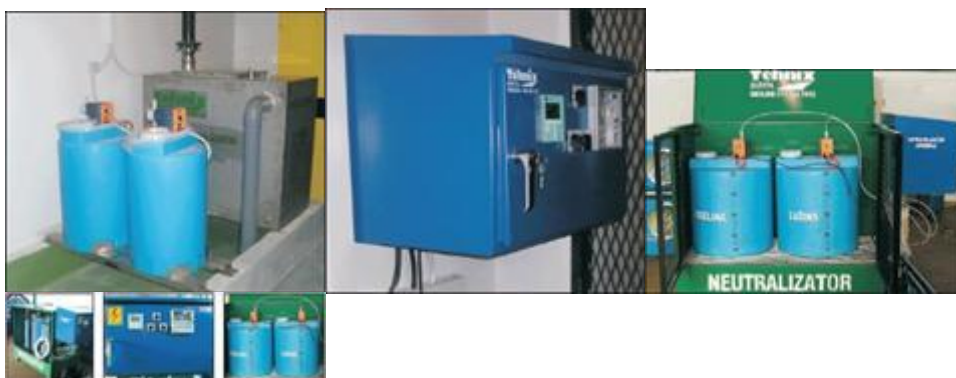
Slika 12. Izgled upravljačke jedinice
