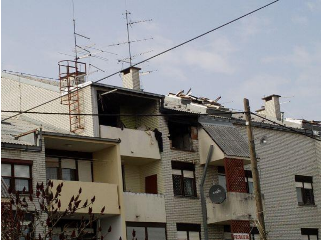
Slika 24. Izgled stana s vanjske strane nakon ugašenog požara.[31]
