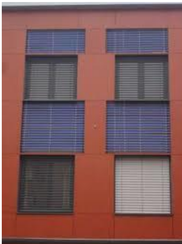
3.12. Vakuumski kolektori na fasadi objekta, Špansko – Zagreb [1]
