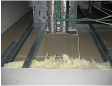
Slika 28. Stanje cijevi ventilacija Trg. centra "Supernova" [14]
