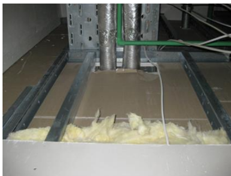
Slika 28. Stanje cijevi ventilacija Trg. centra "Supernova" [14]
