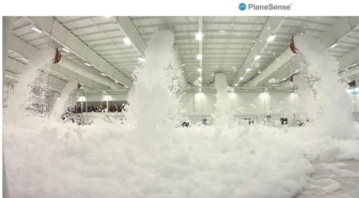
Sl. 21. Stabilni sustav za gašenje lakom pjenom [17]
