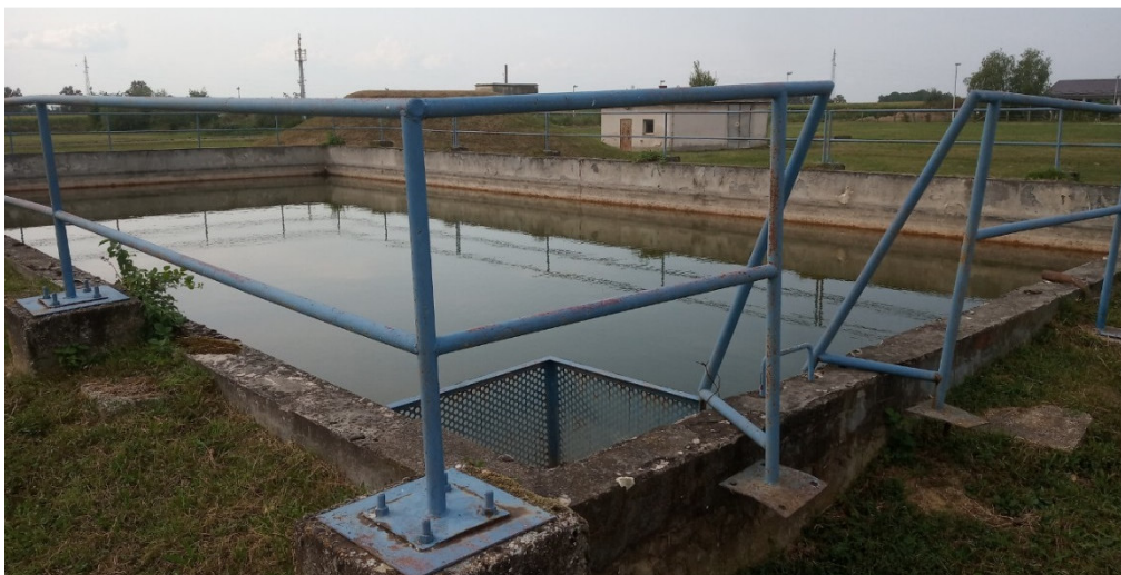
Slika 23 Prikaz poluukopanog spremnika za vodu [14]
