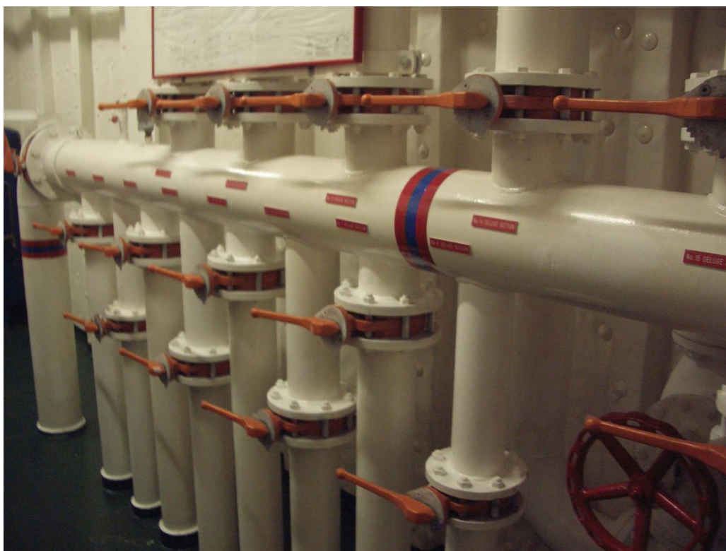
Slika 21. Ventili sustava drencher [17]
