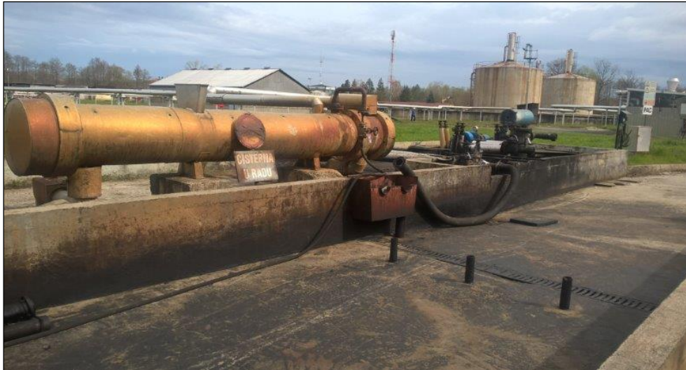
Slika 14. Prihvatište auto-cisterni PAC [2]
