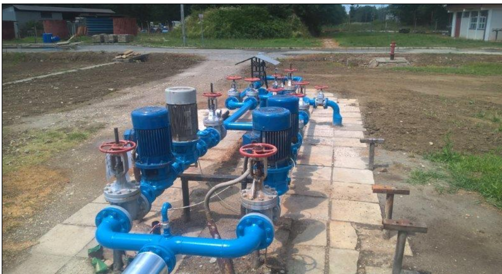
Slika 13. Pumpaona slane vode [2]
