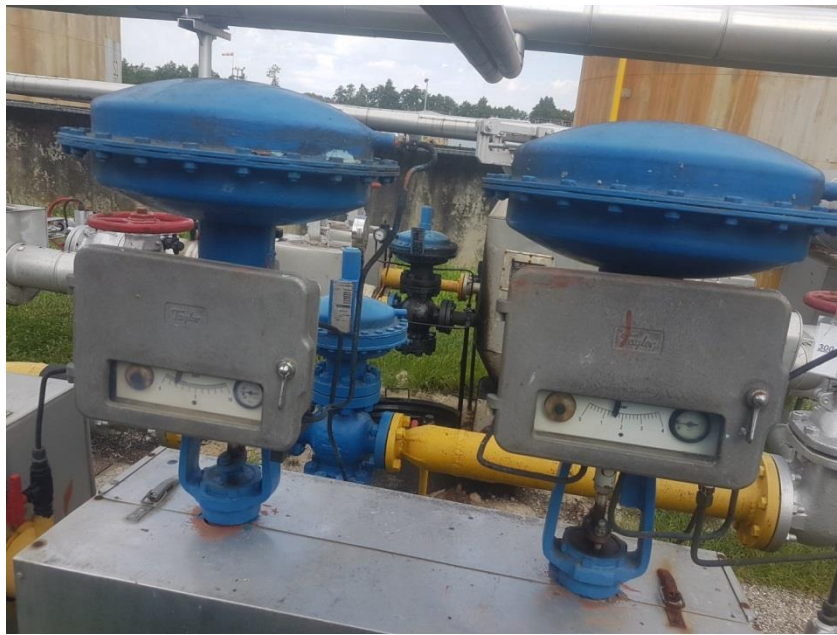
Slika 25. Regulatori na plinskoj rampi s uređajima za postavljanje vrijednosti tlaka
