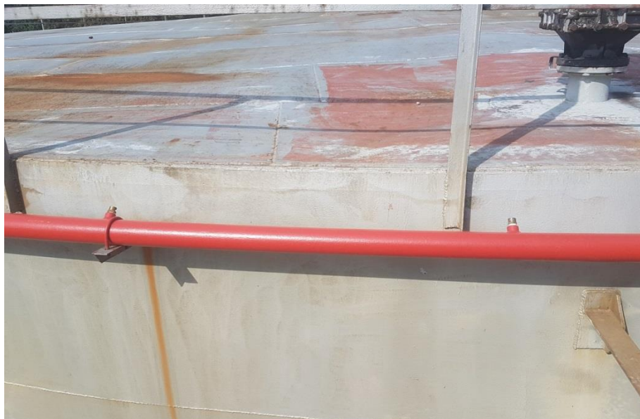
Slika 44. Mlaznice na spremniku R-5
