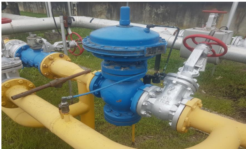
Slika 26. Običan regulator na plinskoj rampi
