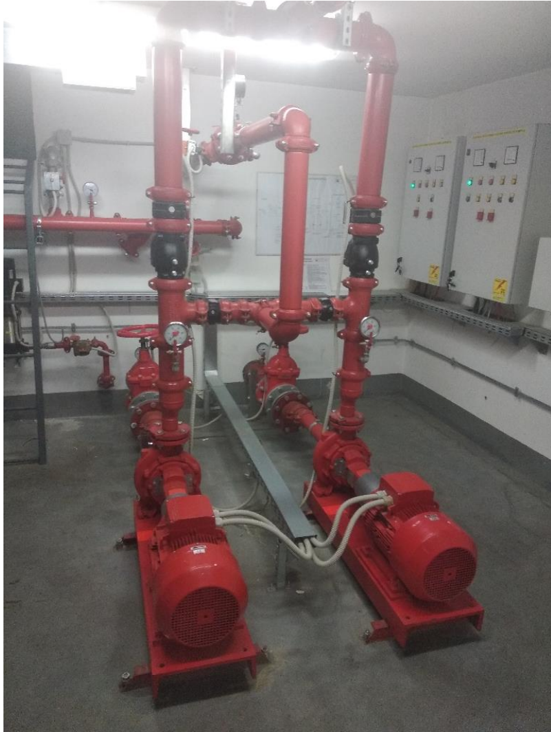
Sl. 12. Cjevovodi sprinklerske stanice [16]
