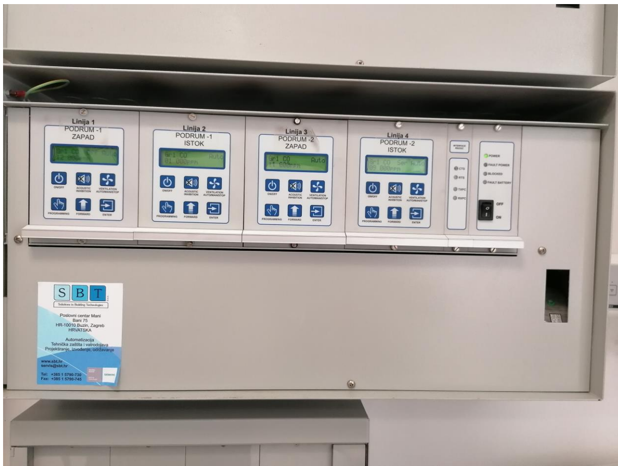
Sl. 20. Upravljačko mjerni uređaj s alarmom i detektorom plina [24]
