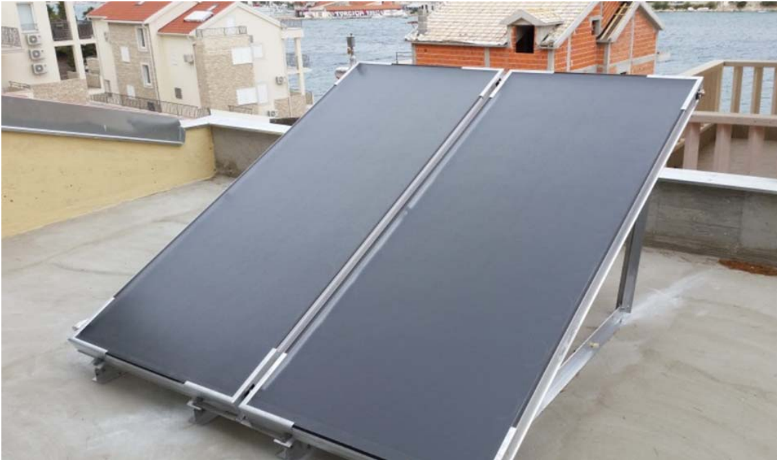
Slika 21. Pločasti solarni kolektori (instalacija na krovu obiteljske kuće) [autor]
