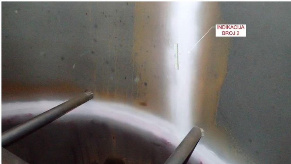
Slika 47. Položaj indikacije broj 2 na vertikalnom tehnološkom zavaru plašta. [2]
