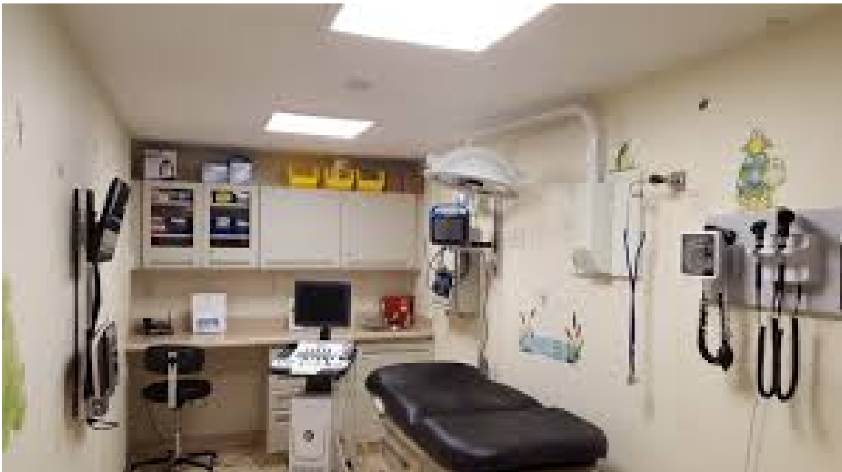
Slika 45. Tipičan izgled kontejnera ambulante na bušaćim postrojenjima
