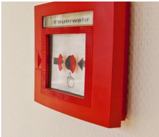
Slika 27. Sustav za dojavu požara [38]
