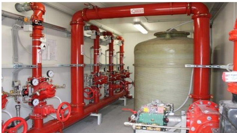
Sl. 6. Sprinkler stanica [17]
