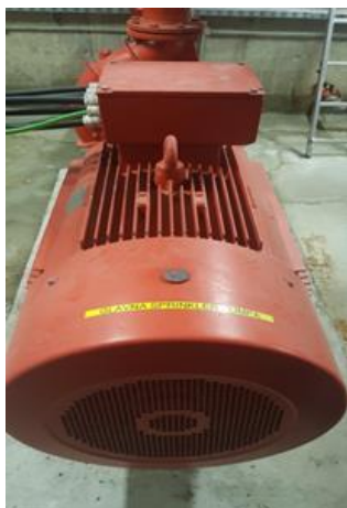
Sl. 9. Glavna sprinkler pumpa [19]
