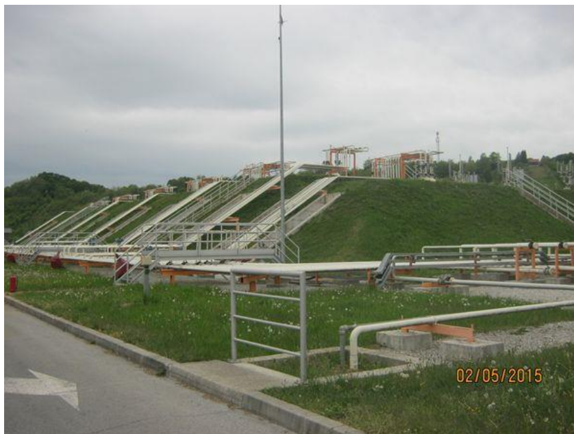
Slika 5. Spremnici terminala (drugi pogled)
