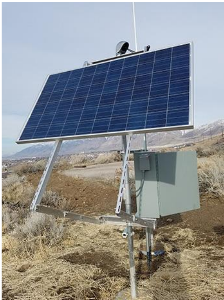
Sl. 2.4. Predodžba: RTU uređaj napajan solarnom energijom. Izvor [8].
