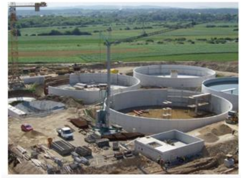
Slika 1. Uređaj za pročišćavanje otpadnih voda [6]
