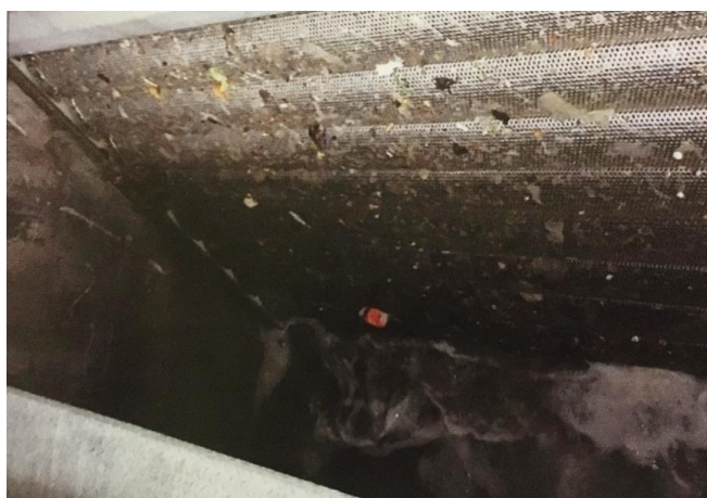
Slika 6. Rešetka uređaja za pročišćavanje u Zagrebu (Tušar, 2009.)
