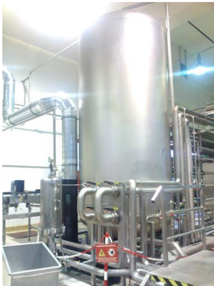
Slika 16. Pufer tank „Fischer“ protočnog pasterizatora
