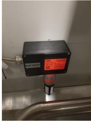
Slika 17. Detektor ispuštanja štetnih ili eksplozivnih para dio je sustava alarmiranja
