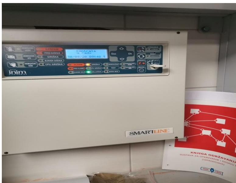
Slika 12 - knjiga održavanja uz vatrodjavnu centralu, Restoran „Labudovac“
