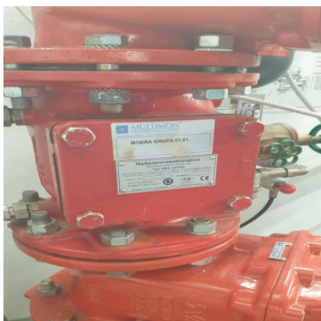
Sl. 16. Sprinkler ventil mokri [10]
