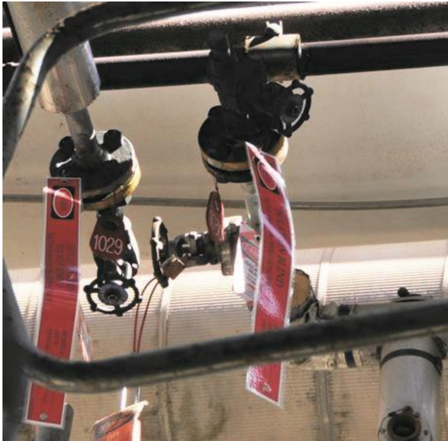
Slika 19: Fotografija izolacije cijevi za opskrbu tekućim butanom u reaktoru alkilacije poslije incidenta. Ova fotografija prikazuje isti cjevovod prikazan na desnoj fotografiji na slici 18. Tesoro je dva dana nakon incidenta u ožujku izmijenio izolaciju cijevi tekućeg butana kako bi odgovarao praksi preporučenog u API-ju, zahtjevima Tesorovih korporativnih standarda i preporukama postupaka Tesoro Martinez odvajanjem i instaliranjem izolacije prirubnice na svakom kraju izoliranog cjevovoda. [Proces safety culture case study Martinez, California, No. 2014-02-I-CA]
