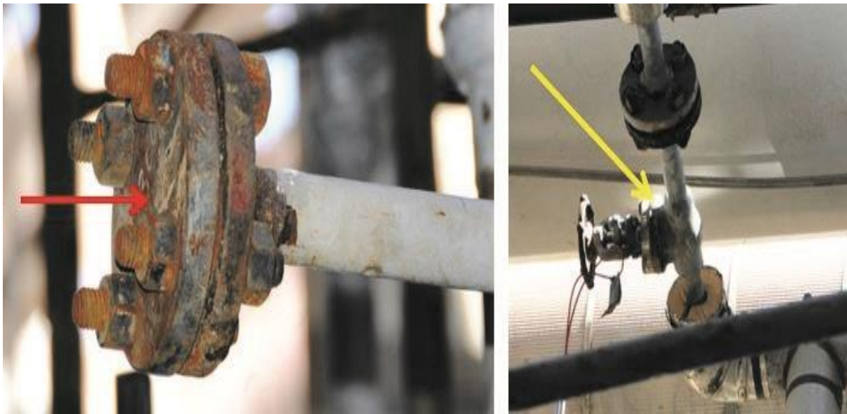
Slika 18: Fotografija izolacije cjevovoda u trenutku incidenta 10. ožujka 2014. godine Fotografija s lijeve strane prikazuje izolaciju cjevovoda na strani reaktora. Slijepa prirubnica (crvena strelica) postavljena je u prosincu 2013. godine, kada je cijev odspojena iz reaktora alkilacije. Fotografija s desne strane (žuta strelica) prikazuje jedan ventil koji se koristio za izolaciju butana. [Proces safety culture case study Martinez, California, No. 2014-02-I-CA]
