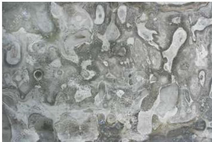
Slika 3. Korozija aluminijskog (Bizgajmer, 2018.)
