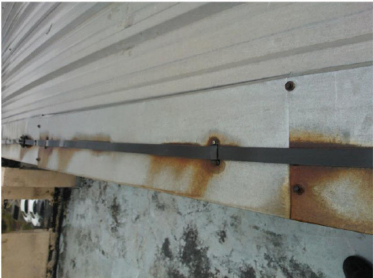
Slika 19. Predodžba oksidirani odvod gromobrana [25]
