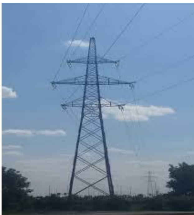
Slika.2.1. jednostruko čelično-rešetkasti stup "jela"
