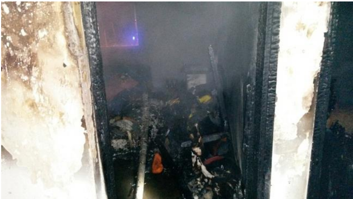
Slika 2. Mjesto događaja nakon vatrogasne intervencije [izvor: autorska fotografija, požar kuće u Lovrentovcu, 24.01.2016. godine]
