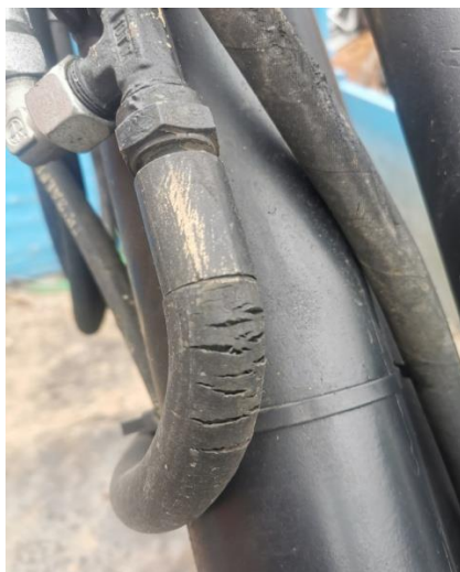
Slika 61. Nepravilno izveden hidraulički vod
