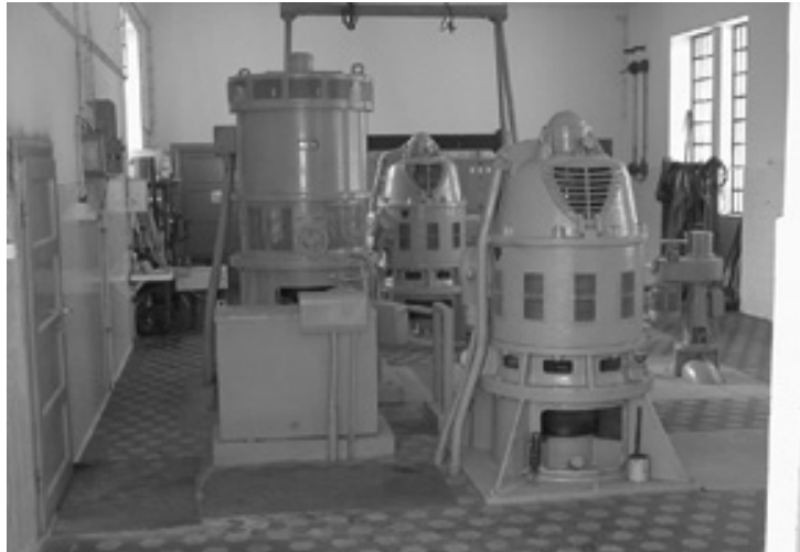
Slika 4. precrpna stanica kanalizacije u Šancu „Draškovićeve“
