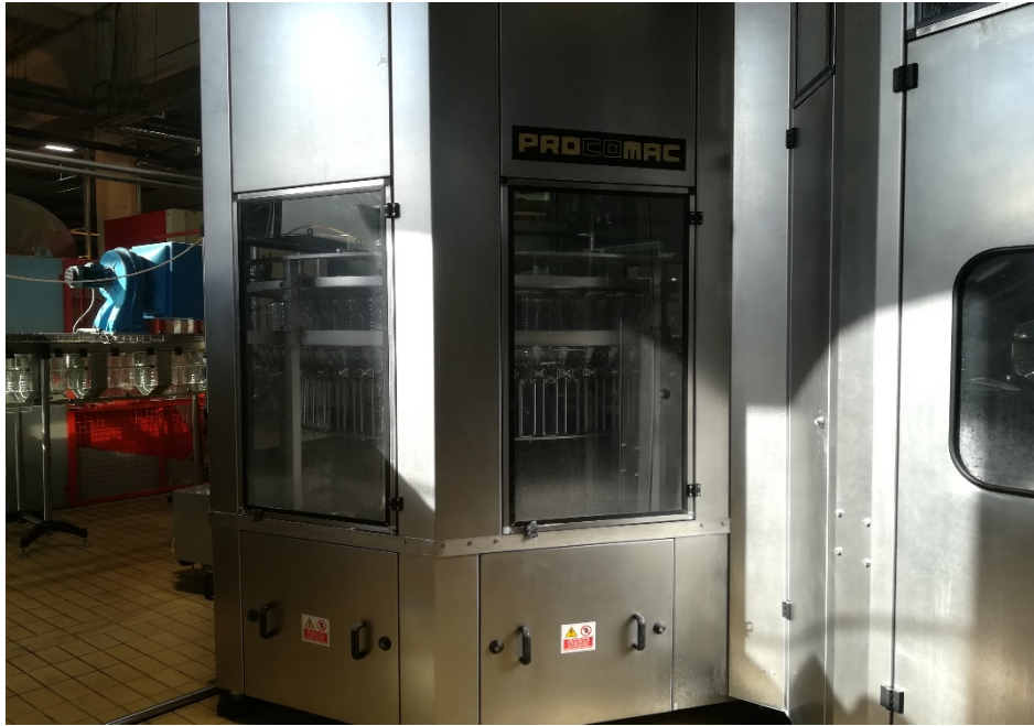
Slika 19. Prikaz stroja sa čvrstom zaštitnom napravom.
