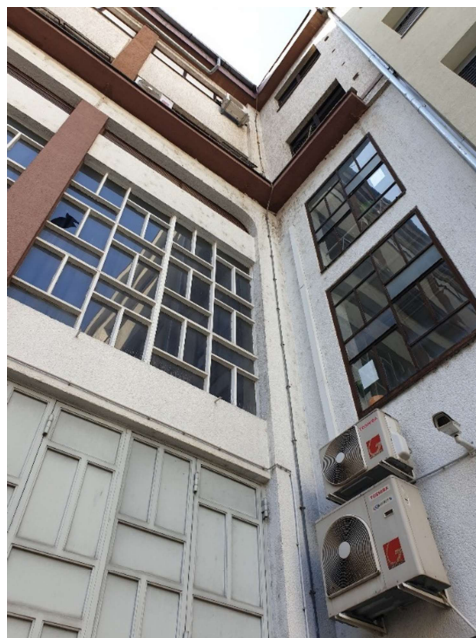
Slika 15. Gromobranska instalacija na zgradi 'Instituta' [13]
