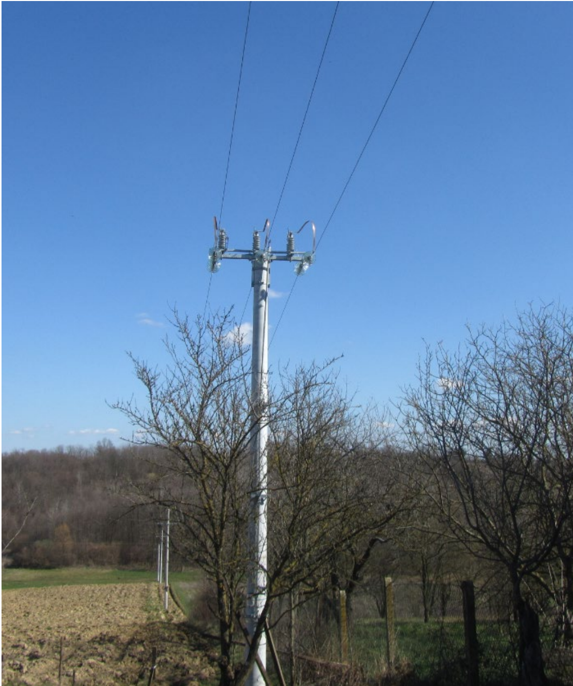
Slika 2 Betonski stup dalekovoda 10kV s linijskim rastavljačem
