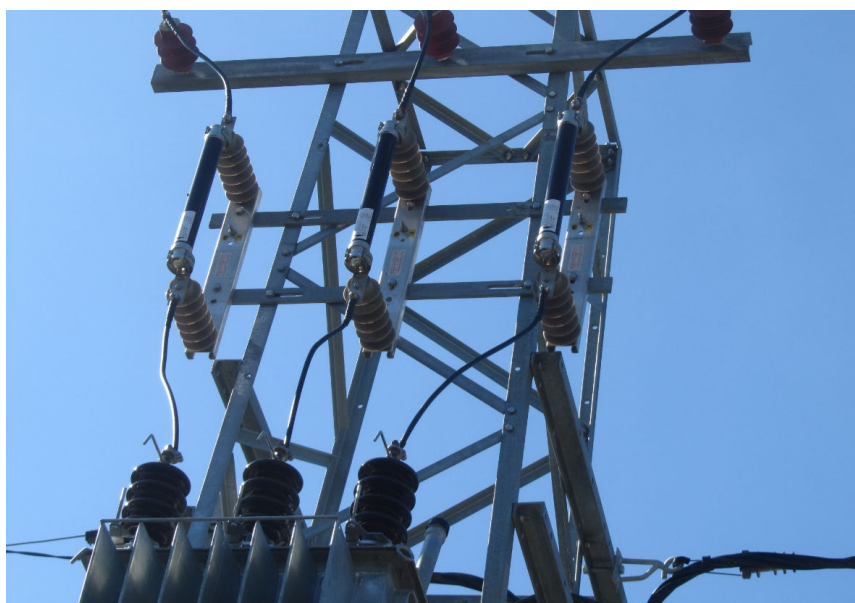
Slika 4 Prikaz dolaza viskog napona na trafostanicu
