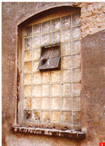
Slika 26. - Prozor ostakljen staklenim opekama nakon požara[32]
