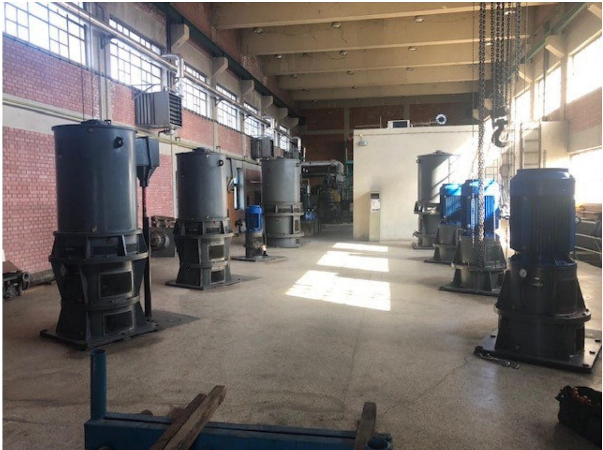
Slika 19. Unutrašnjost pumpaonice s pumpama [7]
