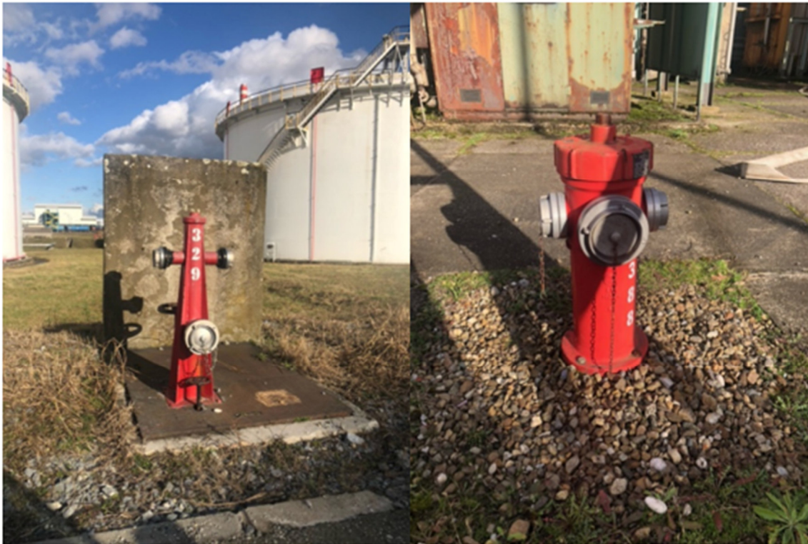
Slika 17. Vanjski nadzemni hidranti "RNS" i "Juring" [7]
