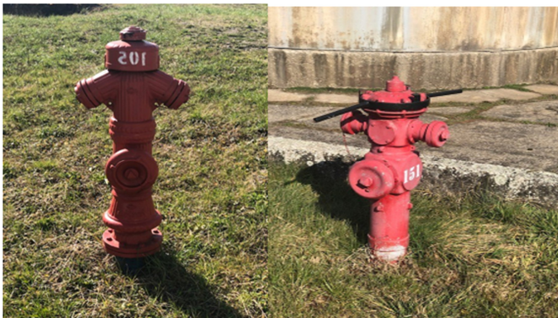
Slika 16. Vanjski nadzemni hidranti "Silvani" i "MIV" [7]
