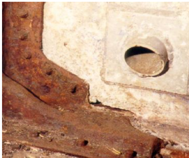
Slika 3.: Elektrokemijska korozija aluminija koji je u dodiru sa čelikom[3]
