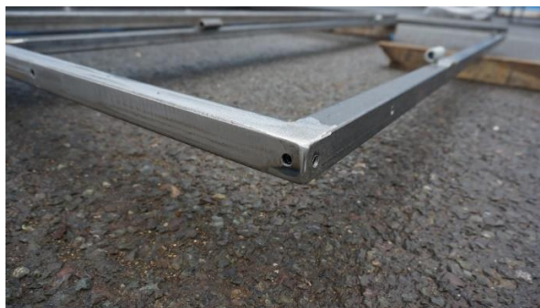
Slika 59. Primjer otvora koji su trebali biti probijeni bliže otvoru (ali to neće utjecati na funkcionalnost elemenata (ali to neće utjecati na funkcionalnost elemenata) [7]
