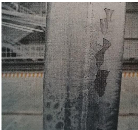
Slika 43. Ljuštenje prevlake na dijelu konstrukcije zbog prevelike debljine prevlake[8]
