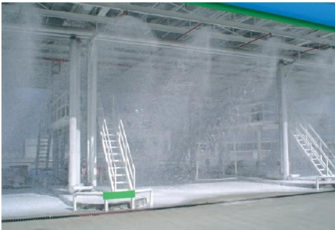
Slika 2. Sprinkler sustav sa pjenom
