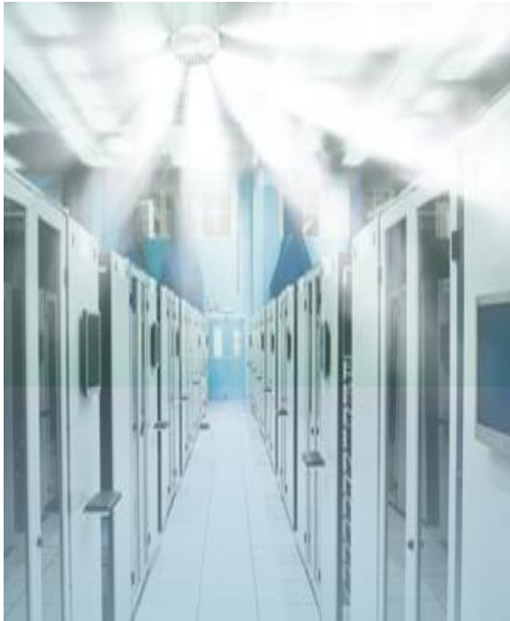
Slika 11. Ispuštanje plina NOVEC 1230 u prostoriji sa računalnom opremom
