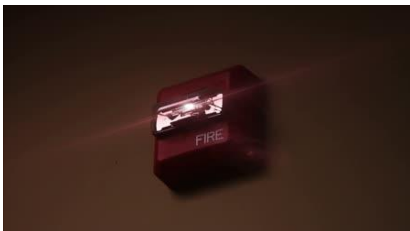
Slika 35. Svjetlosna signalizacija požara
