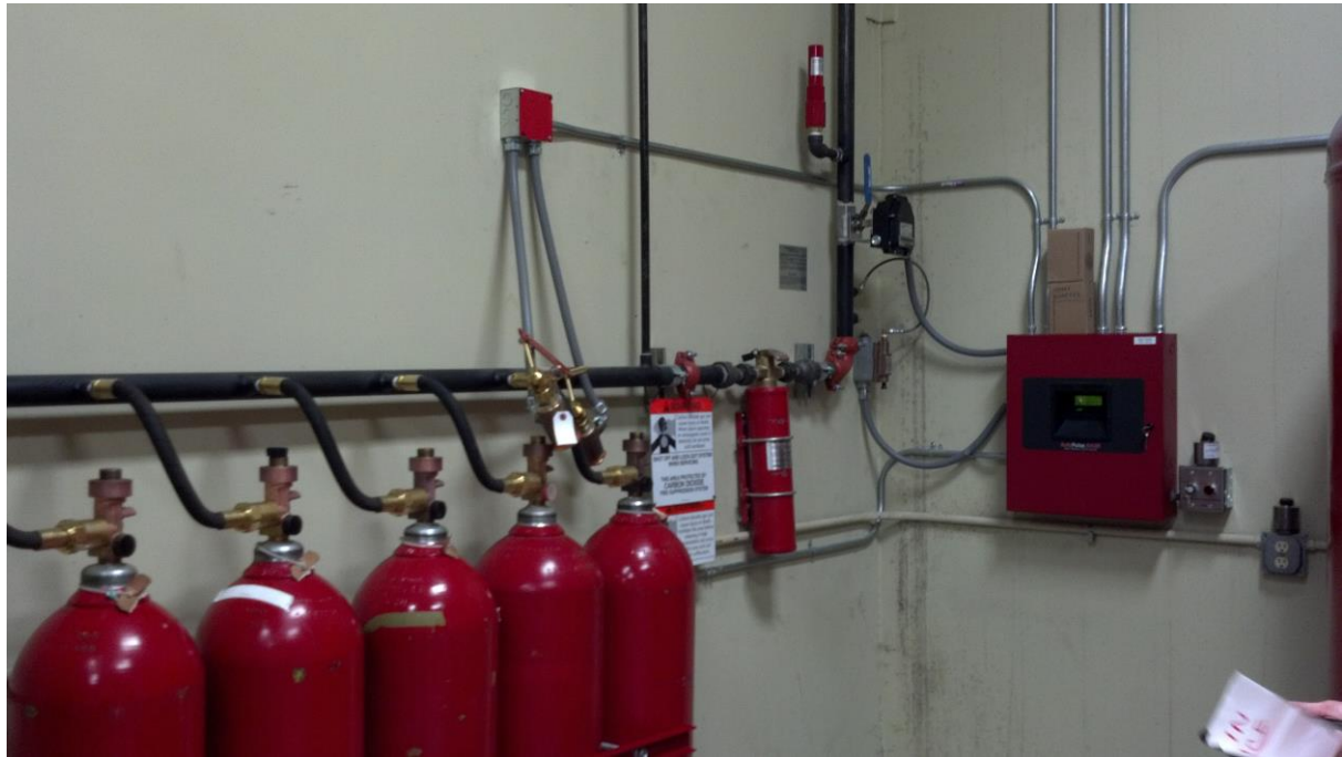
Slika 13. Sustav za gašenje požara sa inertnim plinom (clean agent)
