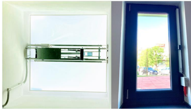
Slika 9. Automatski sustav odimljavanja (otvori za odimljavanje) [1]
