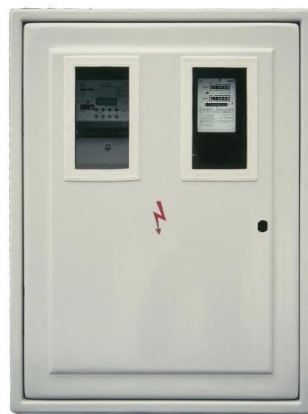
Slika 15. KPMO razvodni ormar [15]
