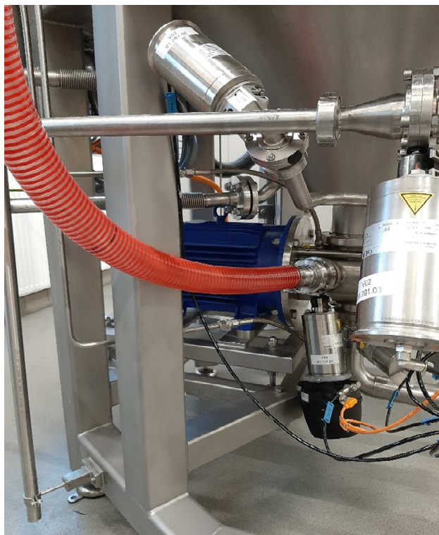
Slika 7. Vakuumska vod za uvlačenje tekuće faze u postrojenje (Izvor: D. Novosel).
