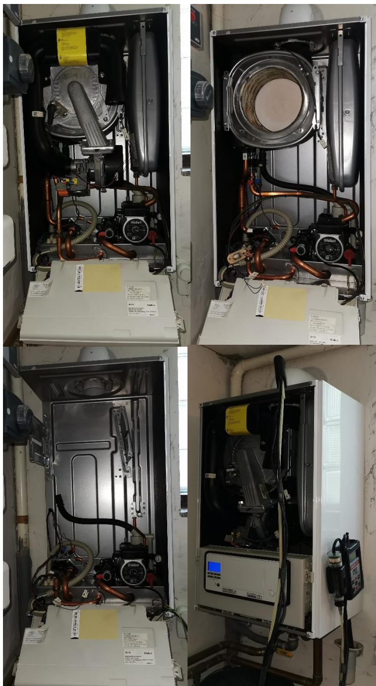
Slika 17: Predodžba servisa po fazama: prvi vizualni pregled, otvaranje, rastavljanje, provjera mjerenjem
