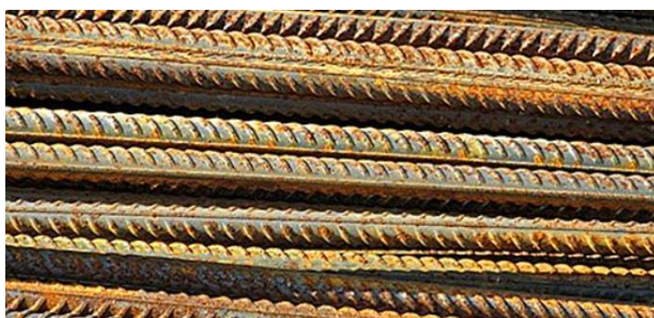
Slika 1: Korozija na armaturnim šipkama [2]
