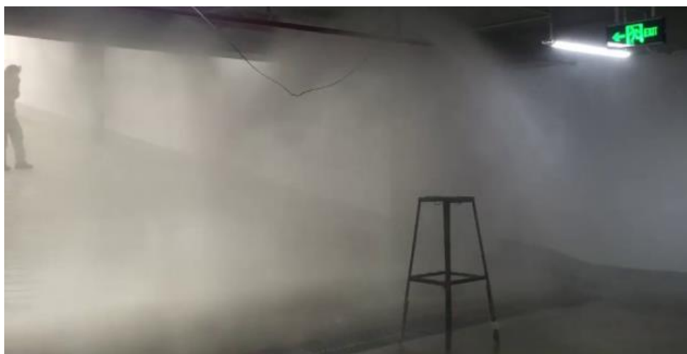
Slika 9. Drencher sustav – vodena zavjesa [7]
