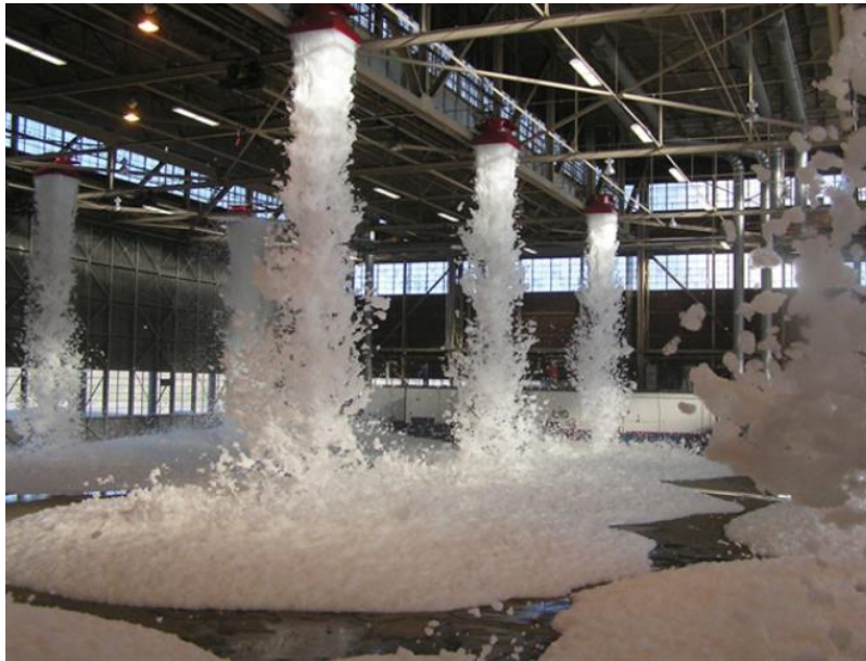
Slika 11. Stabilni sustav za gašenje – pjenom [7]
